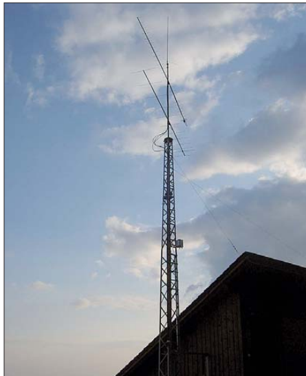
DB0RDH auf dem Grandsberg (JN68KW): als Antenne wird eine X-300 eingesetzt Foto: OV U14
