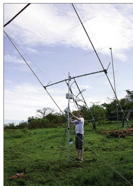
René, PE1L, beim Aufbau und der Feinjustierung der zwei Zehnelement-Kreuzyagis nach DJ9BV
