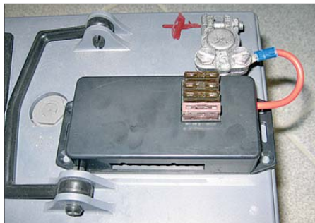
Bild 3: Absicherung eines Notstrom-Akkumulators Fotos: DL51N
